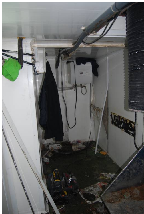
Fotografia núm. 2: àmbit subterrani amb quadres elèctrics i maquinari
